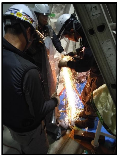
(ロープ切断状況)
