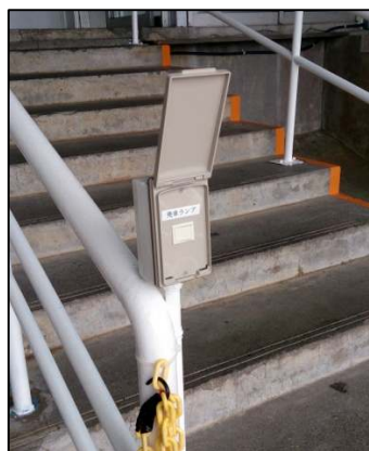
山頂駅確認スイッチ(新設)
